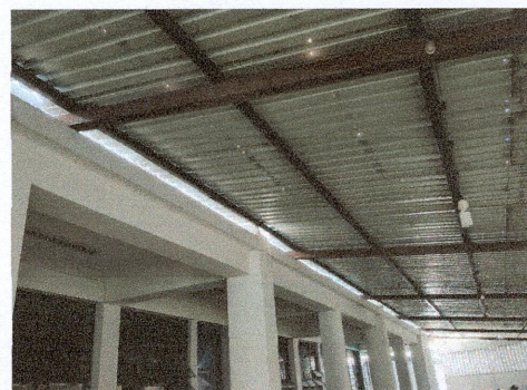
Foto 10: Peligro exponencial en la instalación eléctrica por los daños del techado y deficiencia en la iluminación.
