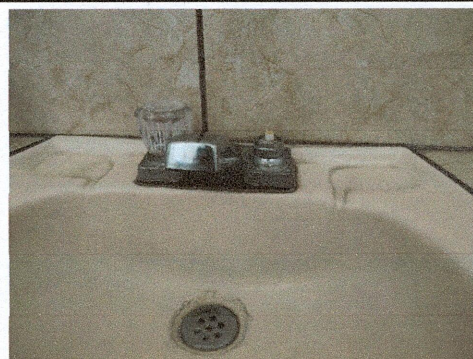
Foto 4: Lavamanos en el baño de mujeres dañado por el uso constante.
