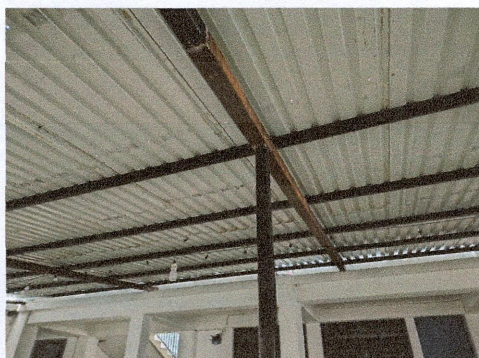
Foto 3: Techado de Lámina oxidado por filtración de agua debido a las fuertes lluvias, visto desde el interior.
