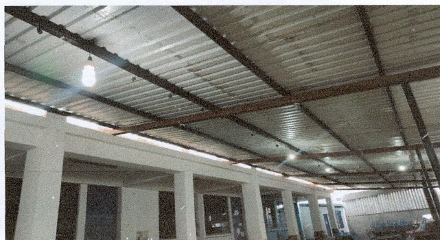
Foto 9: Peligro exponencial en la instalación eléctrica por los daños del techado y deficiencia en la iluminación.
