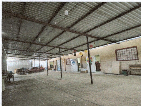
Foto1: Techado de Lámina dañado por las fuertes lluvias, visto desde el interior.
