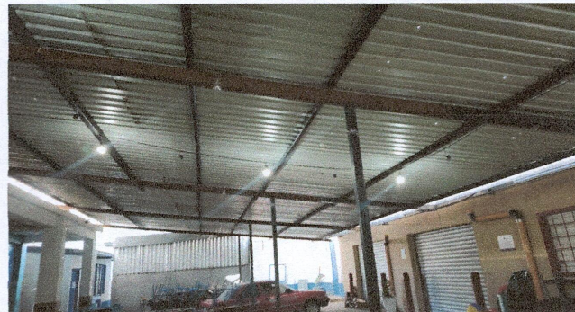
Foto 8: Peligro exponencial en la instalación eléctrica por los daños del techado y deficiencia en la iluminación.
