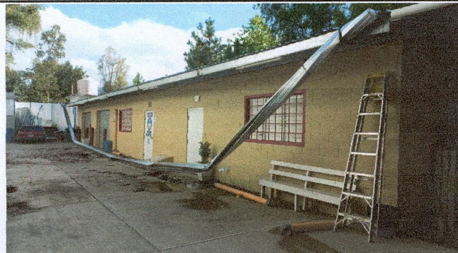
Foto 11: Colapso del canal de aguas pluviales debido a fuertes lluvias.
