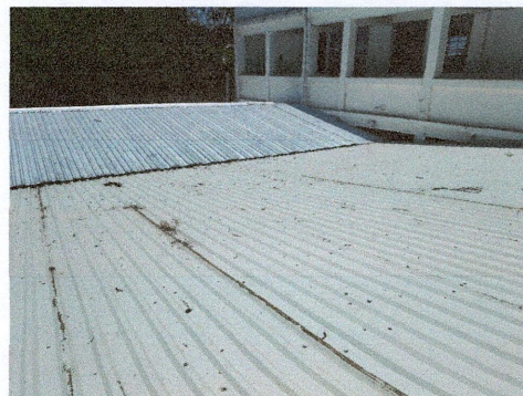
Foto 2: Techado de Lámina dañado por las fuertes lluvias, visto desde el exterior.
