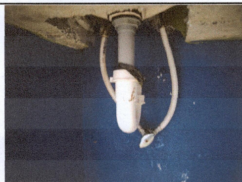
Foto 5: Lavamanos en el baño de mujeres dañado por el uso constante.
