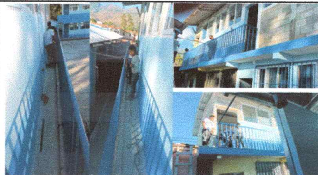
Foto 16: Mejoramiento de baranda de metal, en modulo 2 (750 X 100 cm)
