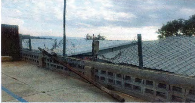
Foto 7: Sustrucción de baranda de metal
