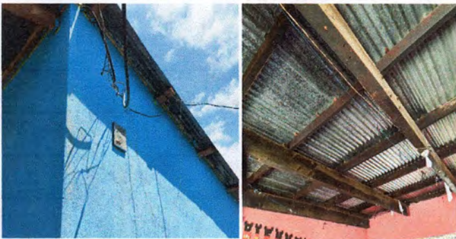
Foto 9: Sustrucción de cableado eléctrico
