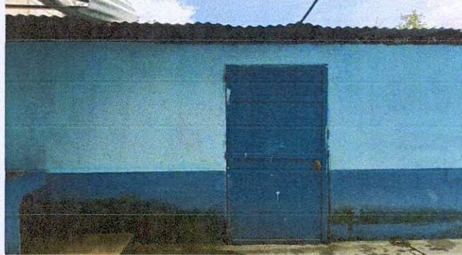
Foto 4: puertas de metal
