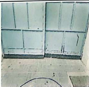
Foto 5: Estado el porton a sustituir.
