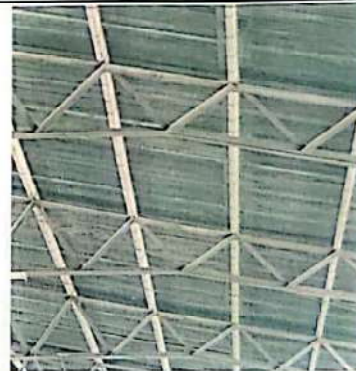
Foto 4: Estructura de soporte de metal oxidada.
