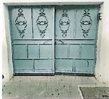
Foto 6: Portón que sera sustituido.
