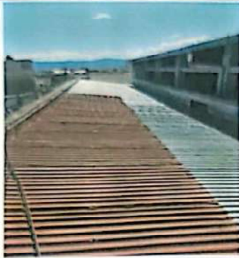
Foto 1: Lámina de las aulas a intervenir en mal estado.
