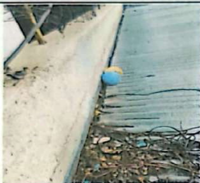
Foto 7: Canal de metal en mal estado.
