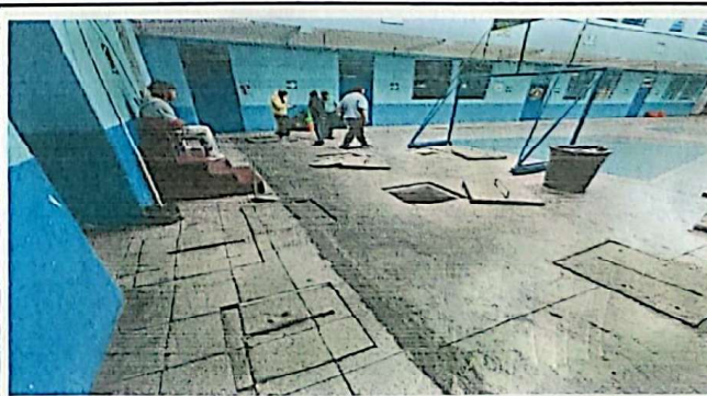
Foto 6: Drenajes en malas condiciones
