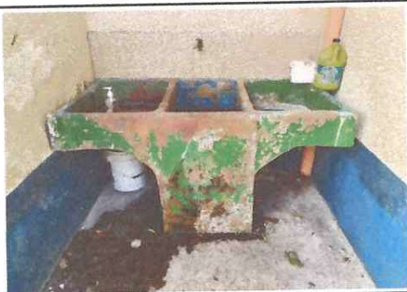
Foto: 5 Cambio de pilas en 4 aulas por mal estado
