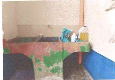
Foto: 6 Cambio de pila por mal estado.
