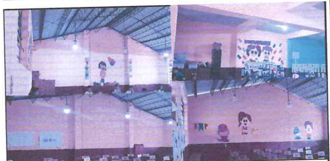
Foto: Pintura interior de aulas
