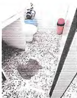
Foto 3: Bomba de agua en mal estado.
