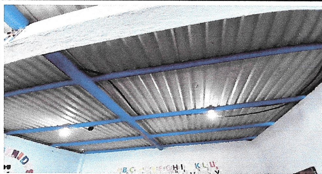
Foto 1: Sustrucción de tornillos y juntas entre láminas por daño causado por viento.
