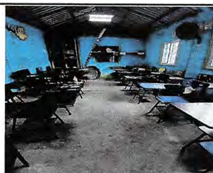
Foto 6: Torta de concreto en salón de 4to. B
