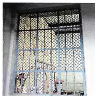
Foto 4: Ventana de cuarto A en mal estado de 1.35 x 1.41 m2
