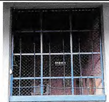
Foto 2: 1 Ventana de dirección en mal estado 1.38 x 1.24 m2
