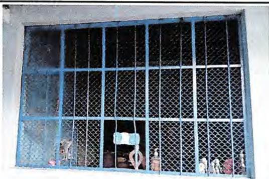
Foto 3: 1 Ventana de párvulos en mal estado de 1.91 x 1.40 m2
