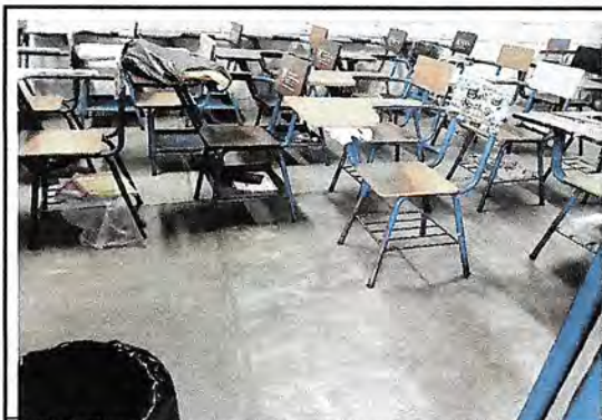
Foto 3: Piso de cemento en aula de cuarto A
