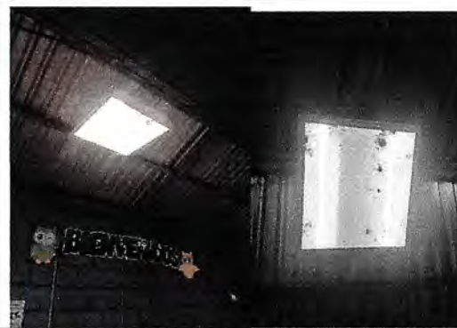
Foto 2: Lámparas en mal estado en salón de cuarto B
