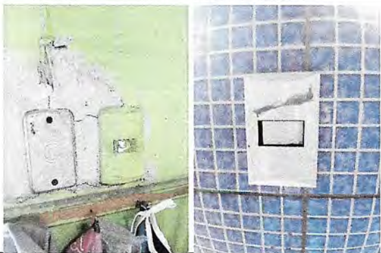
Foto 1: Apagadores en mal estado
