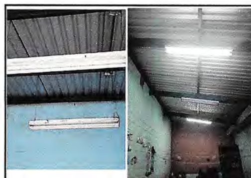
Foto 6: Aula de parvulos con 2 y 4to. A con 3 lámparas en mal estado.
