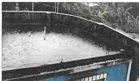
Foto1: Acumulación de Agua sobre la Terraza
