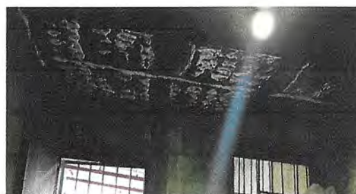
Foto 4: Debido a la humedad se forma moho
