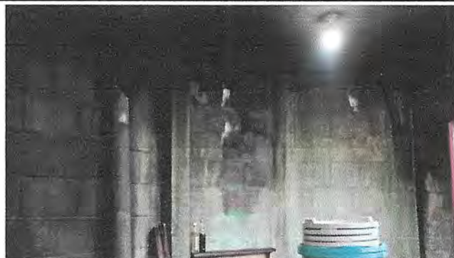
Foto1: Filtración de Agua
