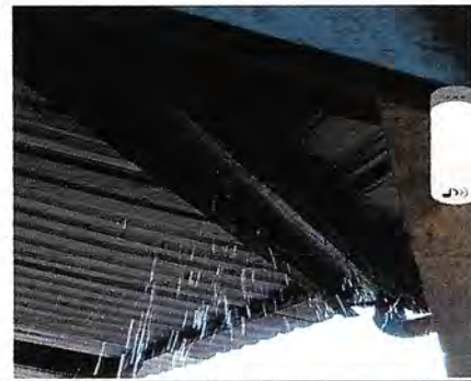
Foto 2: Canal con filtración de agua
