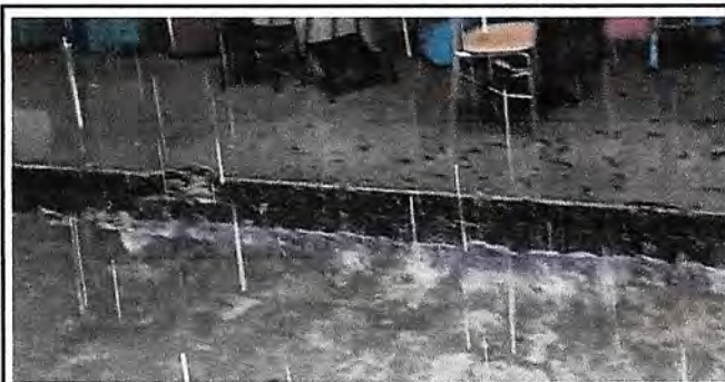
Foto 3: Cuneta de concreto sin rejilla
