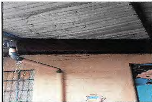
Foto 3: bajada de agua en malas condiciones
