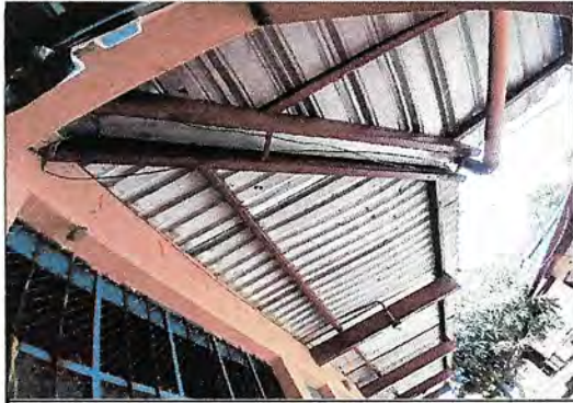
Foto1: Canal de metal, en mal estado.
