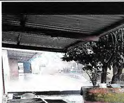
Foto 4: Caída de agua libre sin canal
