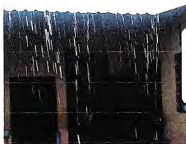
Foto 6: lámina sin bajada de agua
