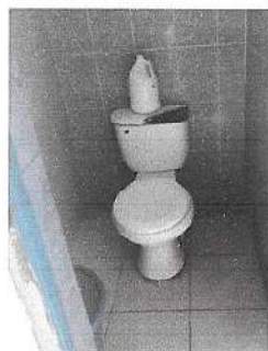
Foto 1: Servicios sanitarios y sus accesorios faltantes
