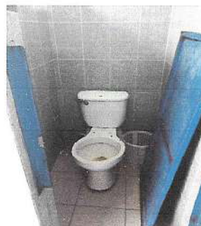
Foto 4: Servicios sanitarios y sus accesorios faltantes
