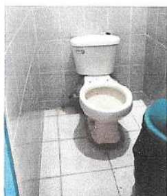
Foto 3: Servicios sanitarios y sus accesorios faltantes
