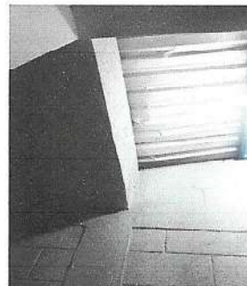
Foto 2: Cubierta de Lamina, sanitarios de maestros, cambio de lamina por agujeros en la mismas.
