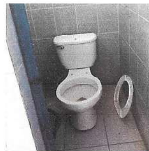
Foto 2: Servicios sanitarios y sus accesorios faltantes
