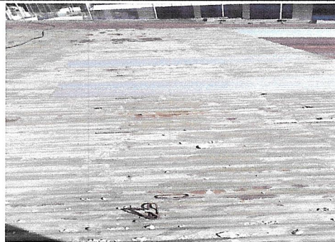
Foto 6: es necesario realizar el cambio de la lámina ya que se encuentra en mal estado tomando en cuenta que la estructura se ve en buenas condiciones.
