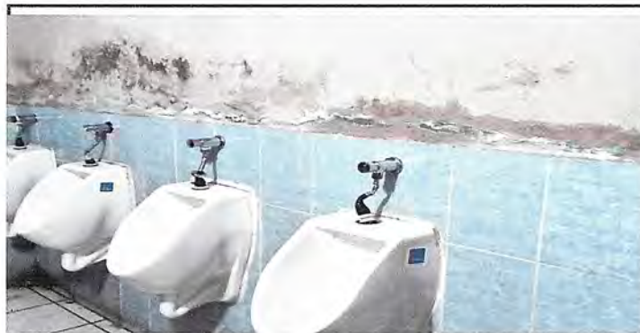
Foto 10: Sanitarios y sus Accesorios Humedad
