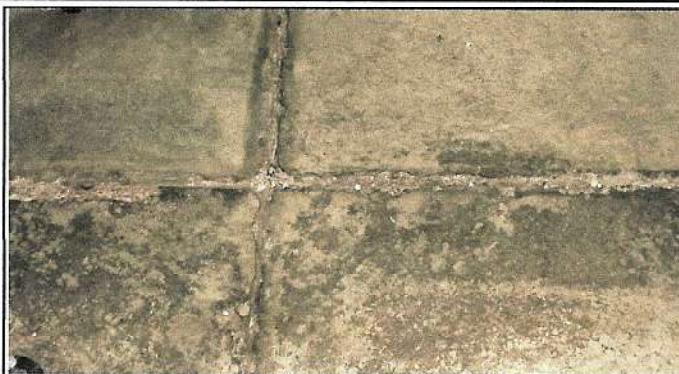
PISO EN MAL ESTADO: PRESENTA GRIETAS Y AGUJEROS
