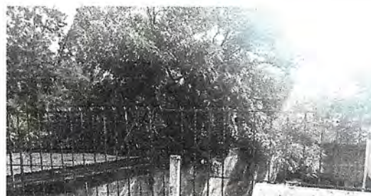
Foto 2: circulación de muro perimetral 1 metro de levantado mas malla area de primer grado costado derecho.
