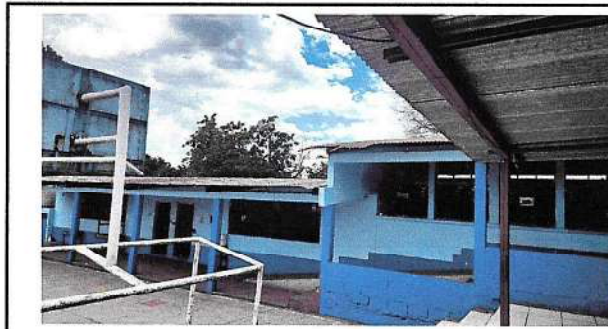
Foto 4: Cambio de láminas en un corredor ya que en épocas de lluvia afecta la filtración del agua ya que la lámina se encuentra en mal estado
