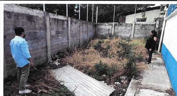
Foto 2: Necesidad primordial habilitación de fosas sépticas para poder habilitar el modulo que cuenta 9 sanitarios para beneficio de los estudiantes.
