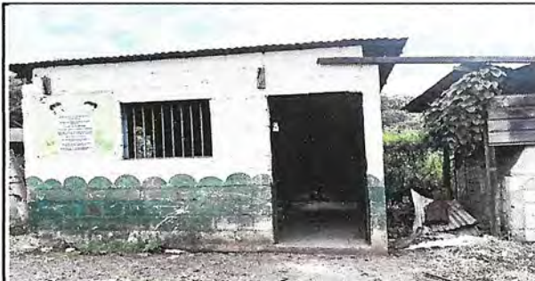
Foto 2: Area de cocina (se realizara el cambio total de lamina y estructura de area de cocina).
