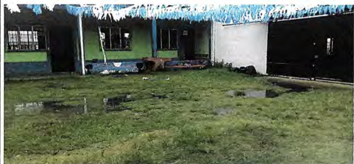
Foto 1: LOSA DE PATIO: Sustrucción de losa de patio por mal estado e inundación en tiempo de lluvia y necesita ser reemplazado para mejorar la seguridad y el aspecto estético del área.
