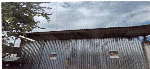
Foto: 1 ASI SE VE ACTUALMENTE EL TECHO DEL PORTÓN DE LA ESCUELA
