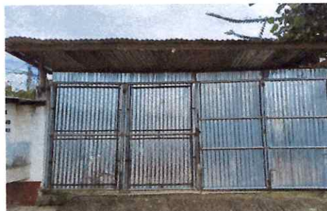
Foto: 2 ACTUALMENTE ESTE ES EL PORTÓN DE LAMINA DE LA ESCUELA
