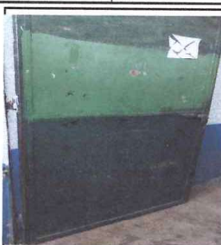
LAS PUERTAS DE LOS 5 SALONES DEBERAN SER REPARADAS
