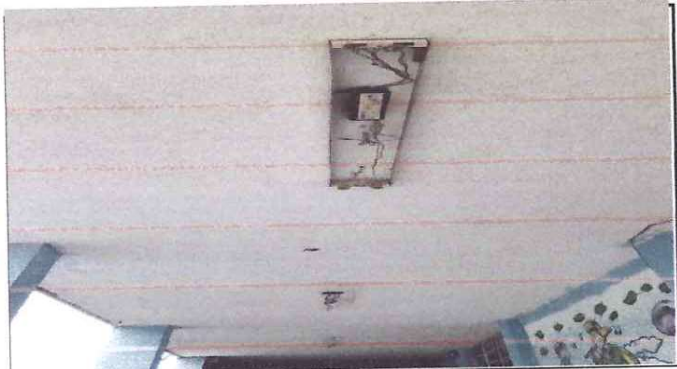
FOTO 4: SISTEMA ELECTRICO Y ALUMBRADO COMPLETO
