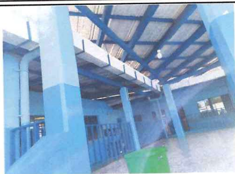
Foto: 1 Se necesita cambiar la dimension del canal y agregar bajada de agua
