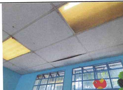
Foto: 4 Cielo falso en mal estado
