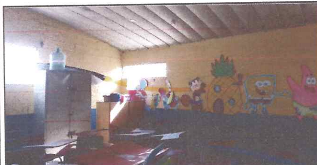
Foto: 5 ventanas pequeñas que no se pueden abrir y no permiten ventilación en los salones.
