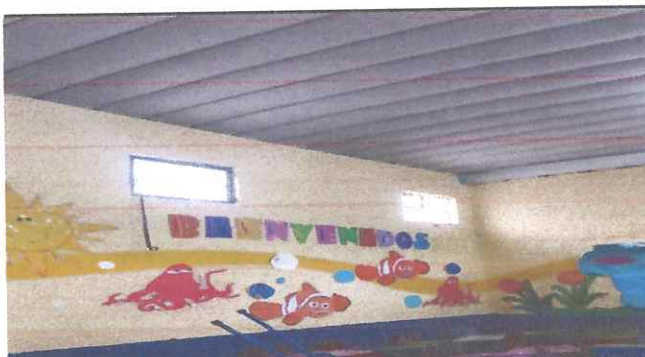
Foto: 4 Ventanas pequeñas sin función ya que no permiten ventilación
