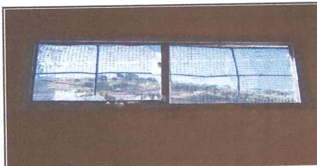
Foto: 6, ventanas sin balcones, pequeñas y con poca ventilación.
