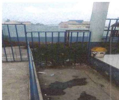
Foto: 2 cambio de rejas de acceso para los juegos, en la fotografía muestra que necesita cambio porque ya no se pueden abrir y son un peligro para los estudiantes.
