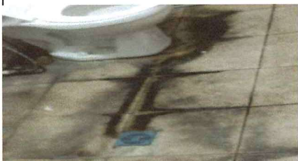
Foto: 1 Cambio de piso del sanitario de docentes la fotografía, muestra el deterioro y la humedad .
