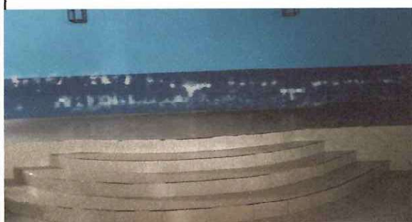
Foto: 3 En la imagen se puede visualizar que los pisos estan deteriorados . La fotografia muestra que solo hay una torta de semento la cual crea mucho polvo.
