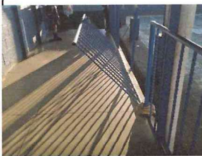
Foto: 4 En la imagen se puede visualizar que la baranda esta deteriorados . La fotografia muestra que el peligro en paso para los alumnos.
