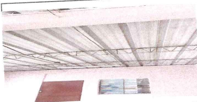
Foto: 4 Cambio de lamina en el pasillo de las gradas para llegar a los salones de clase del modulo 2
