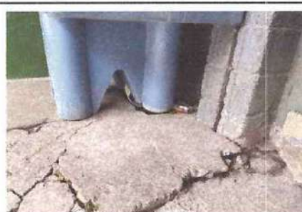
Foto: 6 El desfoga de la pila al drenaje esta mal diseñado
