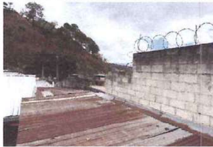
Foto: 2 Cercos en mal estado lado frente
