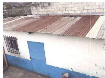
Foto: 6 Lámina en mal estado
