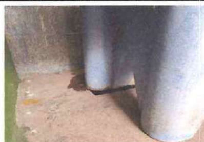
Foto: 4 No desfoga bien en el drenaje
