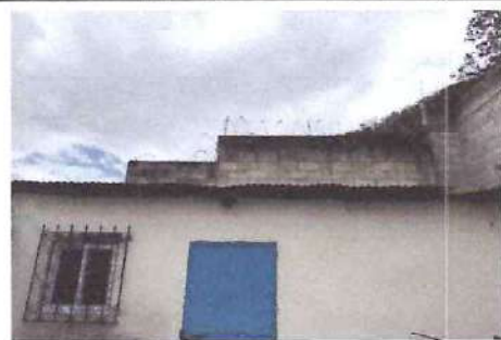
Foto: 4 Lámina en mal estado
