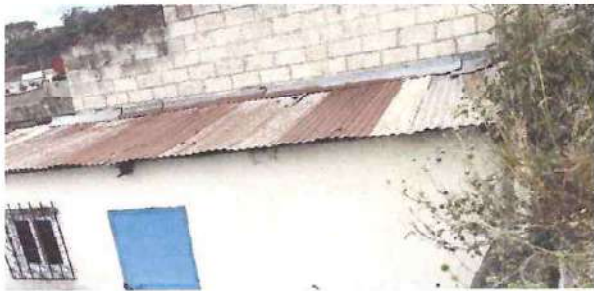
Foto: 1 Lámina en mal estado
