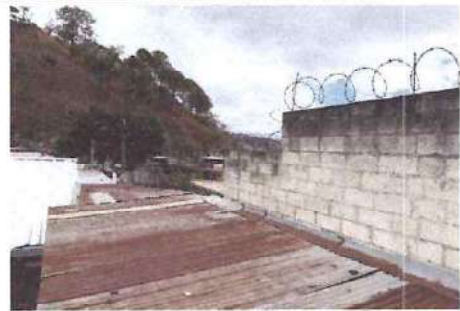
Foto: 2 Lámina mal colocada
