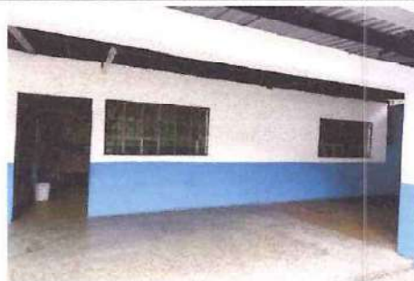
Foto: 2 Ventanas selladas no hay ventilación
