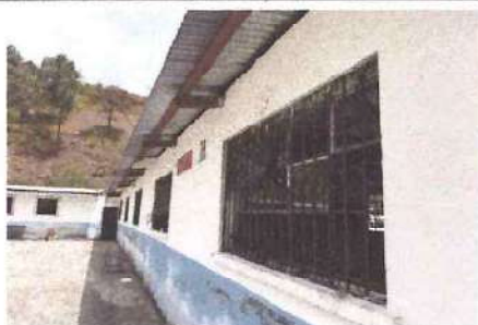
Foto: 1 Ventanas en mal estado
