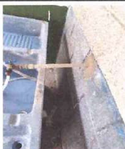
Foto: 3 La tubería de la pila está mal ubicada y la pila de plástico se mueve mucho y se quiebra constantemente la tubería.
