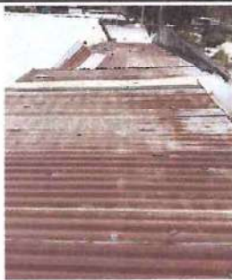
Foto: 3 Filtraciones de agua por lámina levantada
