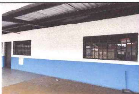
Foto: 3 Ventanas selladas no hay ventilación
