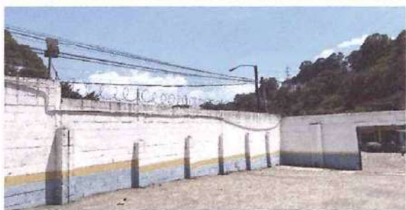
Foto: 1 Cercos en mal estado lado interno
