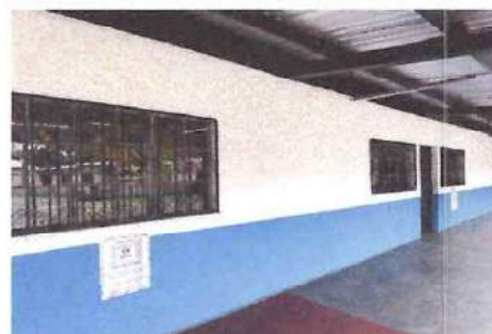
Foto: 4 Ventanas en mal estado y selladas
