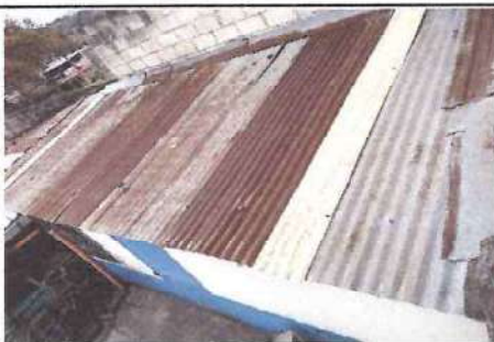
Foto: 5 Filtraciones de agua por lámina levantada
