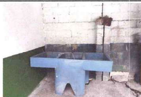
Foto: 2 Mala colocación de pila plástica
