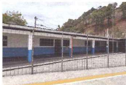
Foto: 6 Ventas en mal estado
