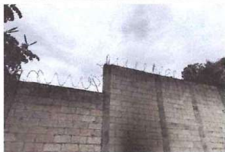
Foto: 5 Cercos en mal estado de la parte de atrás de la escuela
