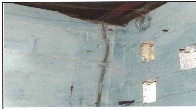
Foto: 4 Se necesita ampliar la entrada de aire y colocar ventana
