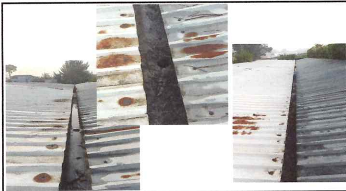
Foto: 1 Mejorar los canales y bajadas de agua en el modulo 1
