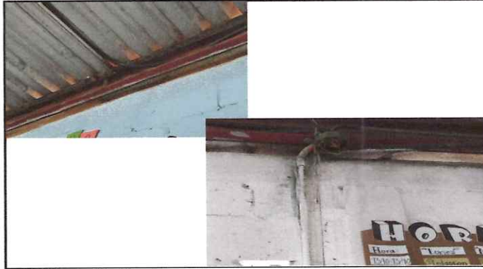
Foto: 2 Se ha identificado un problema recurrente de filtración de agua durante las lluvias en varias aulas
