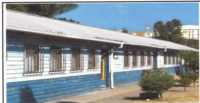
Foto: 5 Se necesita mejorar la estructura y cambio de laminas en modulo de madera
