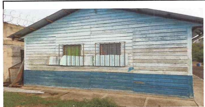
Foto: 6 Se necesita resguardar la estructura que por humedad se esta deteriorando
