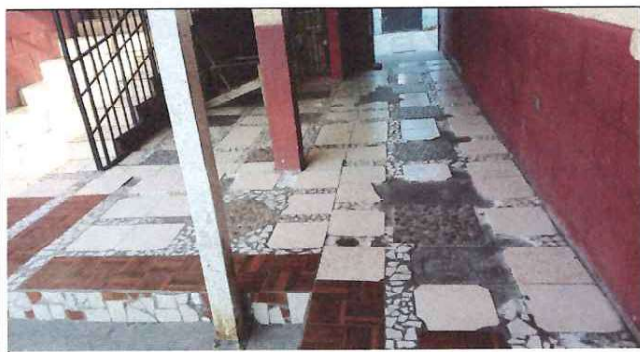
Foto: 3 Estado del piso de corredores.
