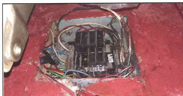
Foto: 5 Mal estado del sistema eléctrico, el cual se encuentra en la cocina y se moverá de lugar.
