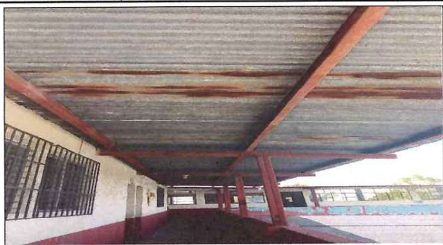
Foto: 1 Estado inicial del techo del corredor
