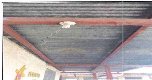
Foto: 6 Estado del sistema eléctrico de aulas y corredores.
