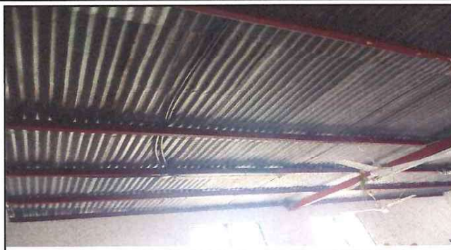
Foto: 2 Láminas en mal estado.
