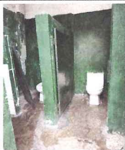
Foto: 1 piso de baños, sin azulejos, puertas en mal estado baño de niños
