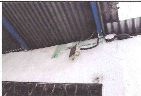
Foto: 1 Cables en mal estado
