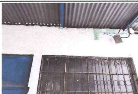
Foto: 3 Sin conexión eléctrica
