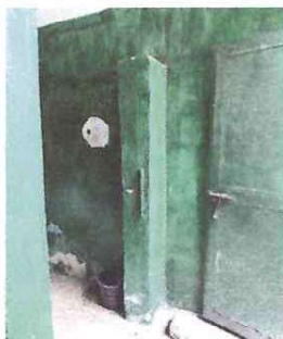
Foto: 3 Pared sin azulejos y sin piso baños de niños
