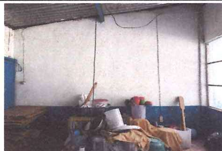
Foto: 6 Cables en mal estado
