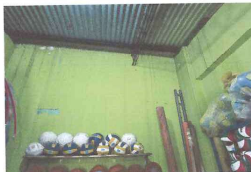
Foto: 2 Eliminar goteo
