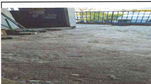
Foto: 3 Piso de corredor en mal estado
