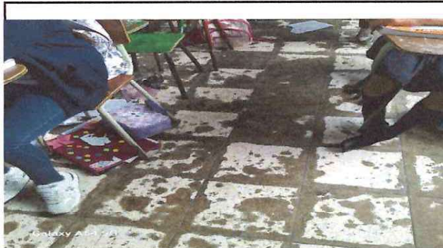
Foto: 2 En la imagen se puede visualizar que los pisos están deteriorados
