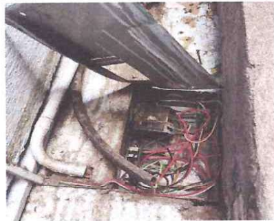
Foto 2: Caja eléctrica 2 planta baja
