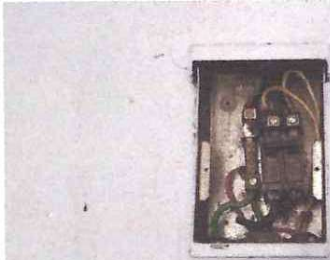
Foto 1: Caja eléctrica 1 planta baja
