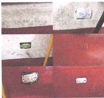
Foto 3: Tomacorrientes grados 1ro. 2do. 3ro. Secciones A, B, C
