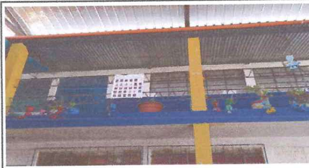
Terminar las barandas para evitar accidentes
