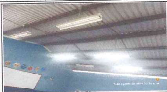
Foto: 1 Energía eléctrica en salón
