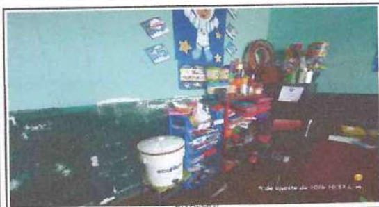
Foto: 3 Impermeabilización en salón
