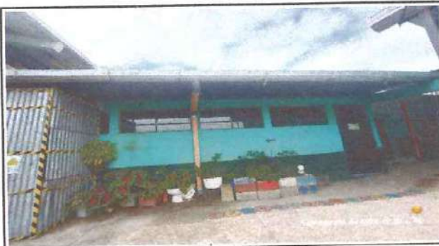
Foto: 10 Salón para cambiar de lámina
