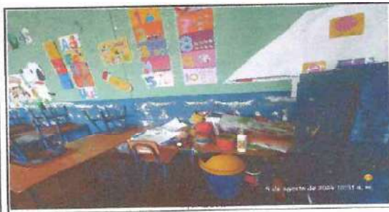
Foto: 5 Impermeabilización en salón
