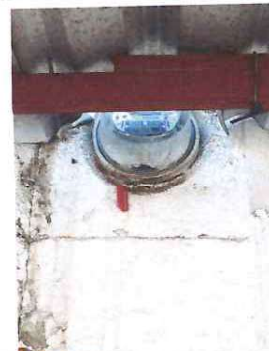
Foto: 4 Verificación en contador
