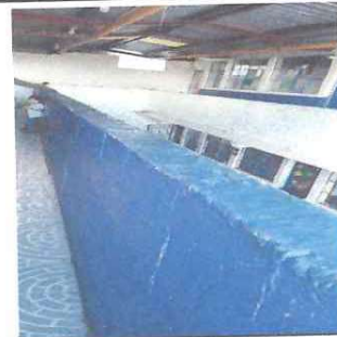
Foto: 2 Reforzar muro y agregar baranda
