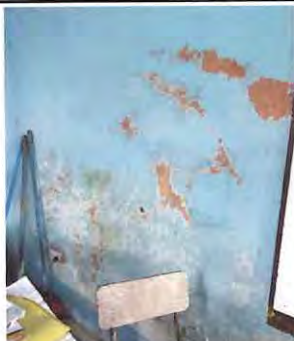
Foto: 1, Mantenimiento de pared por filtracion de migitorios.
