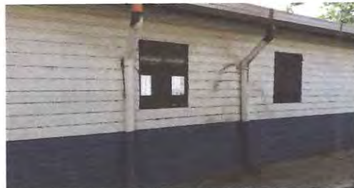
Foto: 8 Área detrás de los salones que requiere impermeabilización
