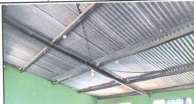
Foto: 2 salon con tencho dañado
