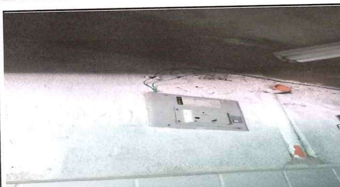
Foto: 3 instalaciones eléctricas en mal estado
