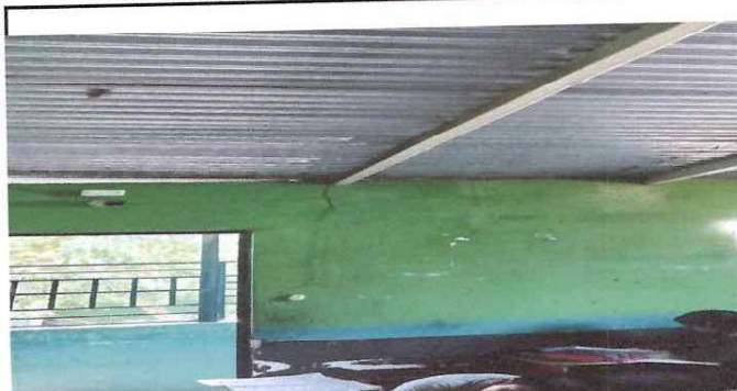
Foto: 4 techo e instalación eléctrica en mal estado
