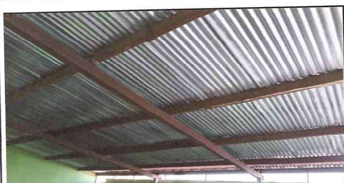
Foto: 5 salon con filtraciones
