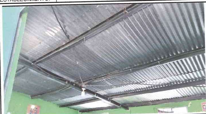
Foto: 1 salon con excesos de goteras
