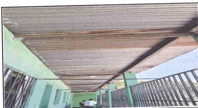
Foto: 6 techo dañado, oxidado
