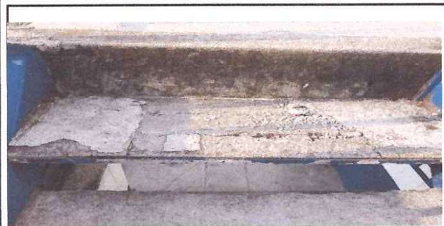
Foto: remozamiento de gradas en mal estado
