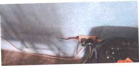
Foto 2: El establecimiento cuenta con pocos tomacorrientes de los cuales se sobrecargan.
