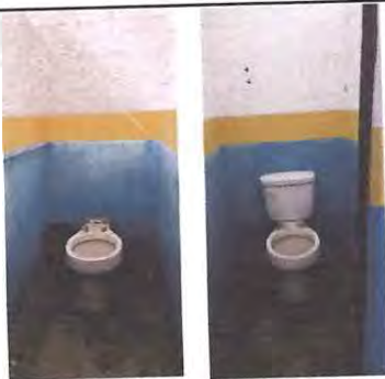
Foto 6: Los inodoros se encuentran en mal estado y sin funcionamiento por falta de accesorios y/o fugas.
