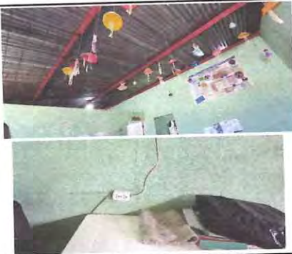
Foto 4: Existen instalaciones de luces y tomacorrientes de manera improvisada e inadecuada.
