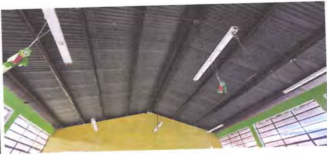
Foto 1: En las aulas no se tiene iluminación, solo existen las bases de las candelas.
