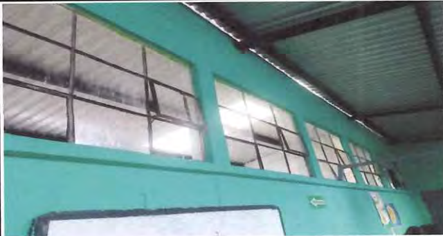
Foto: 4 Retirar los balcones, para que entre ventilación cruzada. Y se refresquen los salones, repello
