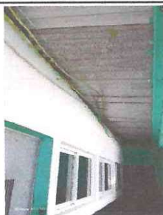
Foto: 1 Se necesita mejorar el sistema electrico de la escuela
