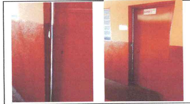
Foto 6 : Puerta sin chapa 2do. C/Chapa mal estado
