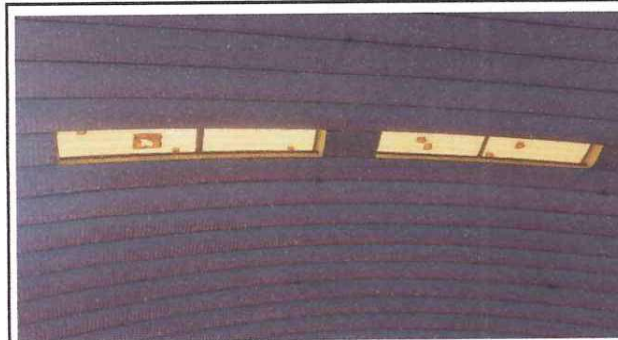
Foto 4 : Láminas dañadas del domo
