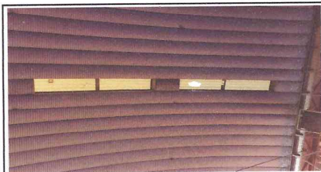
Foto 3 : Láminas dañadas del domo
