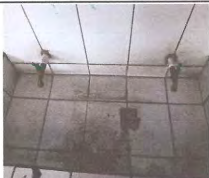
Foto: 3 AL MOMENTO QUE SE OBSTRUYE LA TUBERÍA ES IMPOSIBLE REALIZAR EL DESTAPADO CORRECTO YA QUE NO HAY TUBERÍA VISIBLE.
