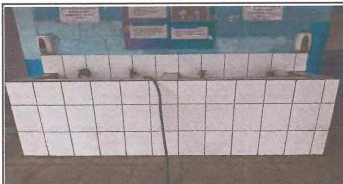
Foto: 4 LA ESTRUCTURA DE LA PILETA DIFICULTA LA HIGIENE ADECUADA PARA LA MISMA Y DEBIDO A LA TUBERÍA DE PVC LAS LLAVES SE QUIEBRAN FRECUENTEMENTE.
