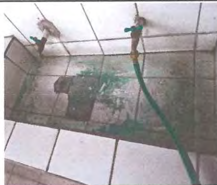
Foto: 2 LA ESTRUCTURA DE LA PILETA DIFICULTA LA HIGIENE ADECUADA PARA LA MISMA Y DEBIDO A LA TUBERÍA DE PVC LAS LLAVES SE QUIEBRAN FRECUENTEMENTE.
