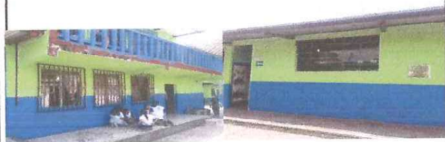
Foto 3: Ventanales en mal estado, se reemplazaran por ventanas de PVC
