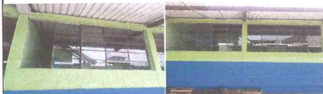
Foto1: Ventanales en mal estado, se reemplazaran por ventanas de PVC
