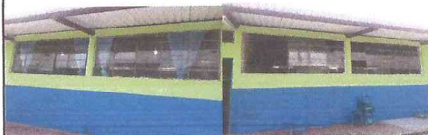
Foto2: Ventanales en mal estado, se reemplazaran por ventanas de PVC
