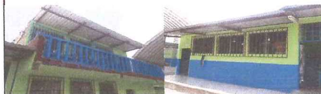
Foto 4: Ventanales en mal estado, se reemplazaran por ventanas de PVC
