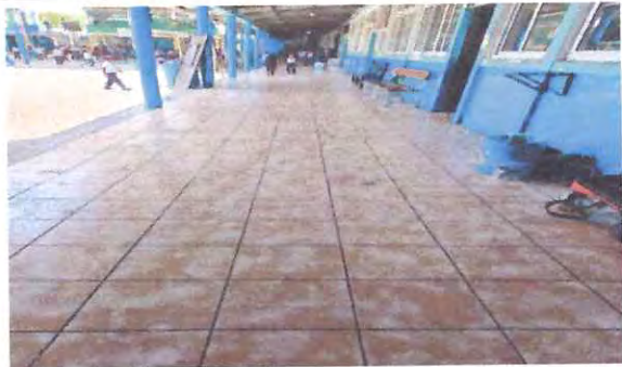
Foto 1: Piso del pasillo lado este - norte
